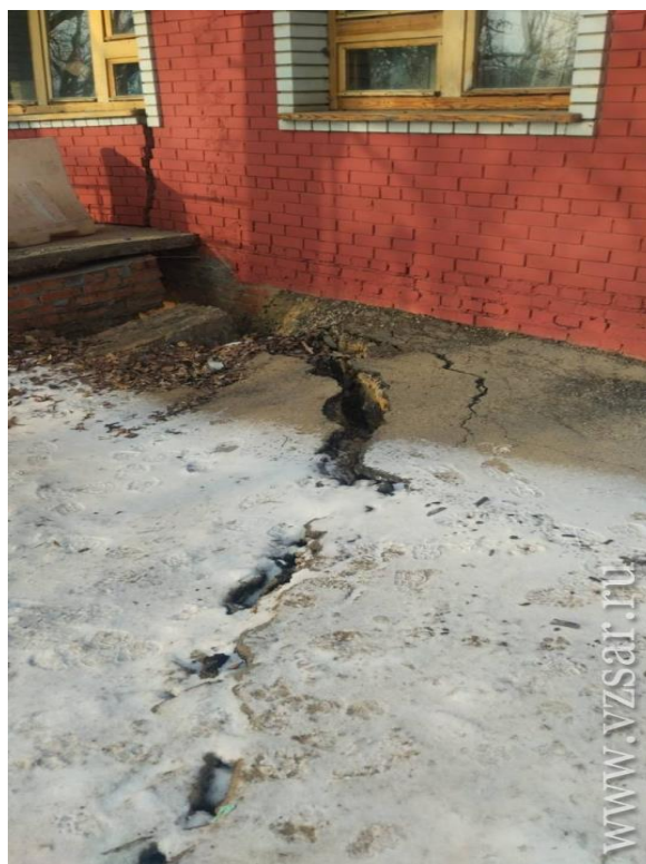
Рисунок 1 – Оползневой процесс близ постройки на турбазе «Хуторок» в Саратовской области [1]
